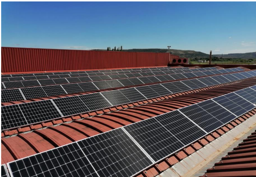
Instalación solar fotovoltaica de autoconsumo en Bodega Pinnafidelis (Coop. Cocope)
