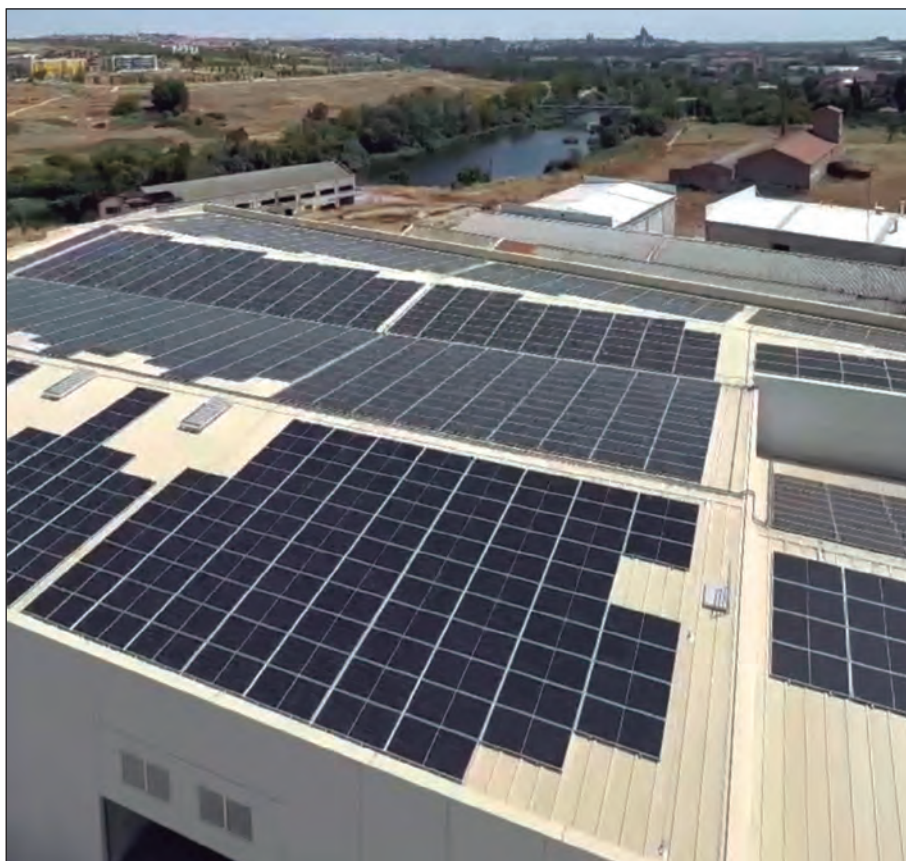
Planta solar fotovoltaica en las instalaciones de Copasa.
